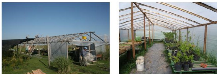
Fotos: reparación del vivero dañado por una tormenta.
